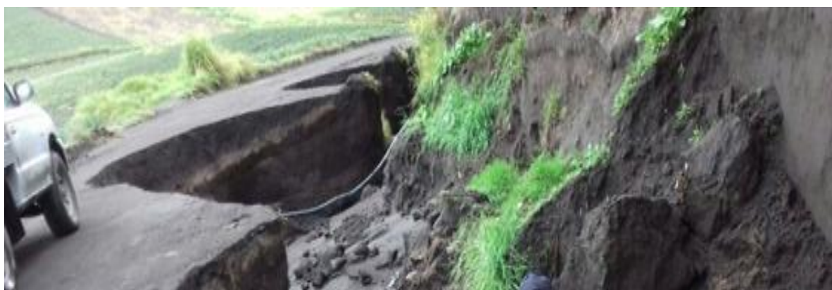
FOTO 6. Santa Fe de Galán afectada por fuerte lluvia
